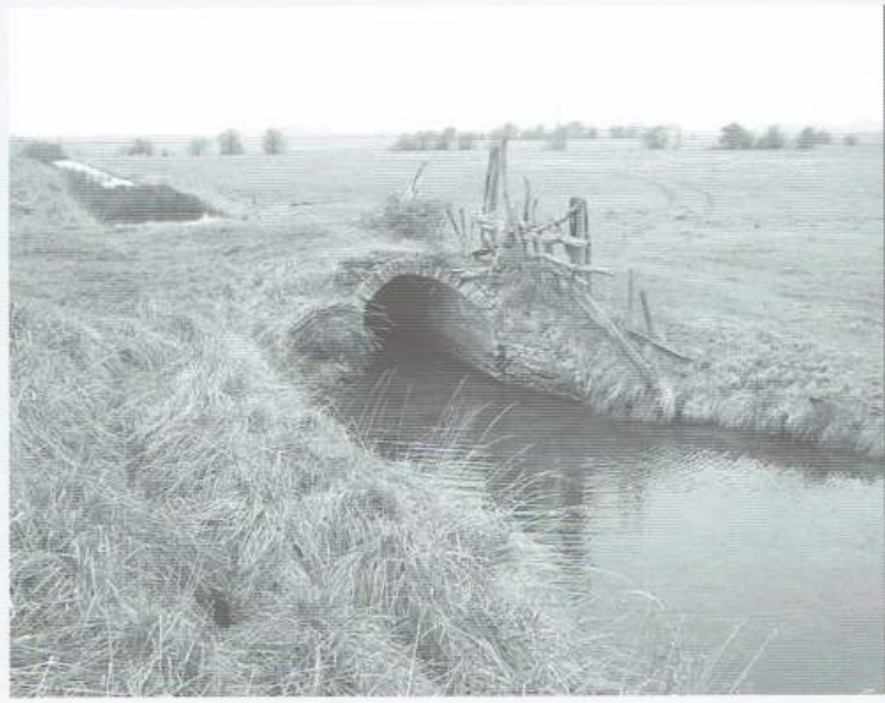
Heul aan binnenzijde dijk langs Kanaal door Walcheren vóór restauratie
